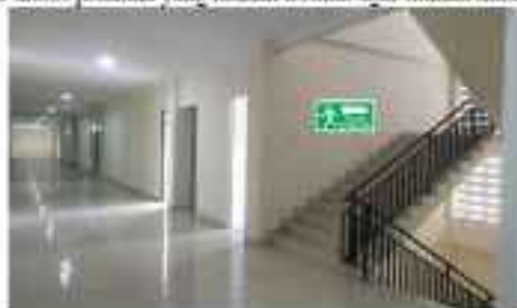
Gambar 6. Foto Jalur Exit Evakuasi
